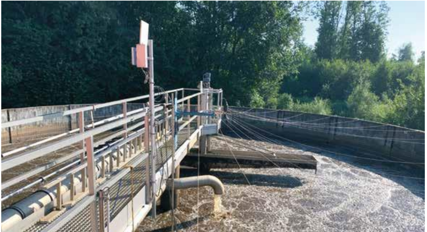
Utilisation de NeoWaterFX300 dans le réacteur SBR d'Avenches (Suisse)
