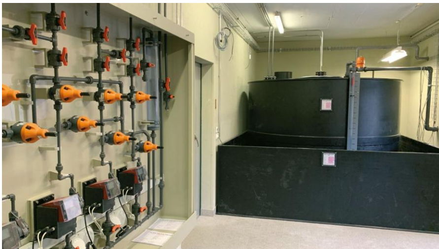
Ensemble de la citerne d'un 14 m 3 Réservoirs avec tableau de dosage et bac de rétention
