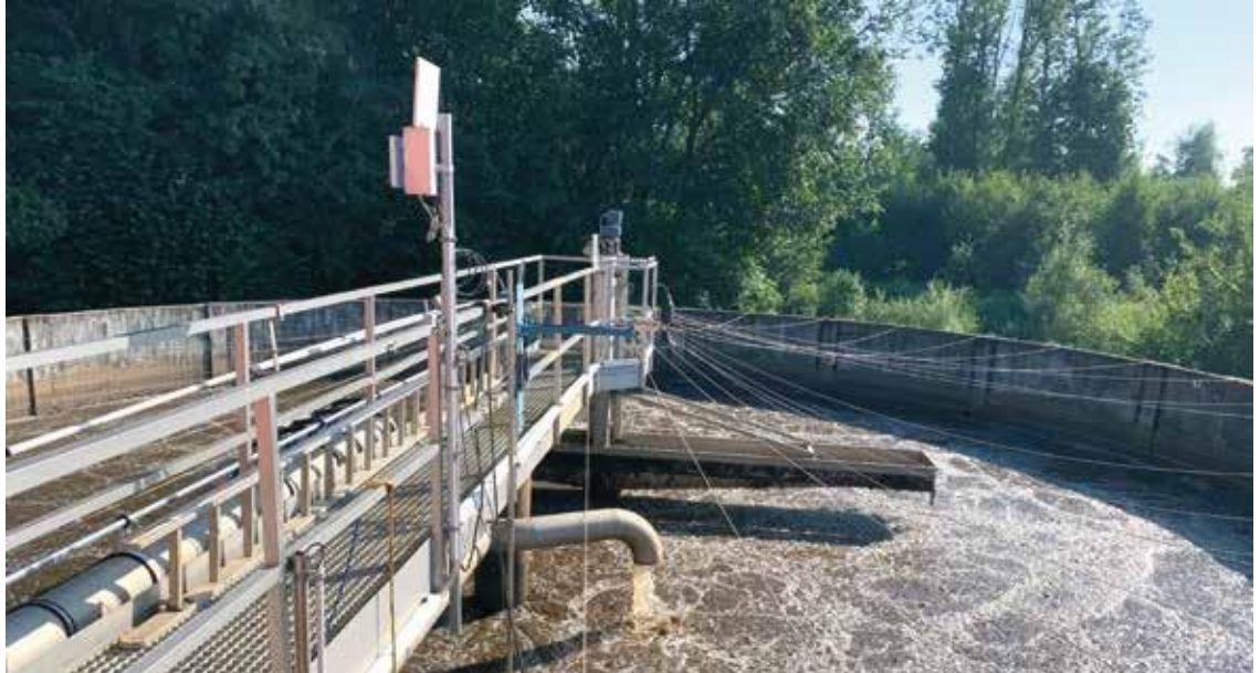
Fig : Utilisation sur le Réacteur SBR à Avenches (Suisse)
