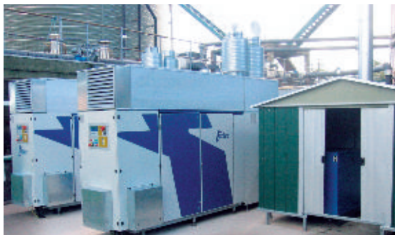
In der Praxis bewährt – die Turbec T100 Serie 3 (im Bild als Aussenanwendung einer Kläranlage)
