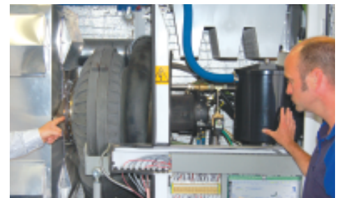
Stefan Fertig, chef de station, est très satisfait de son installation turbec .
