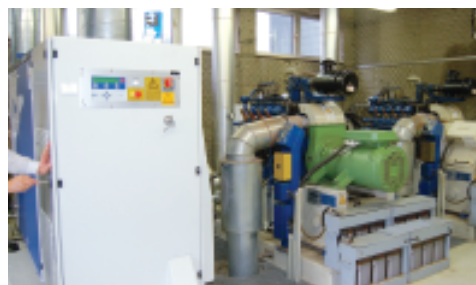
La nouvelle turbine turbec à côté des deux moteurs à gaz existants.
