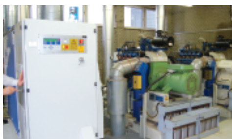
Die neue turbec -Anlage neben den beiden bestehenden Gasmotoren.
